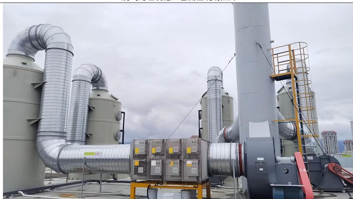
废气配套废气收集管道、处理设施及排气筒
